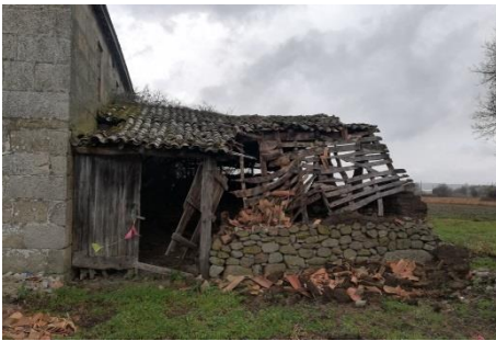
Construcción con terrones en 2014 y ya arruinada en 2023. (Fernández Palicio)
