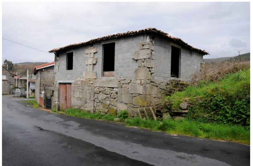
Muro donde los terrones fueron substituidos con ladrillos y bloques de hormigón. Trabazós, parroquia e Concello de Sandiás. 2013. (Fernández Palicio)
