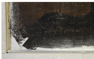
Fig. 53. Esquina inferior izquierda. Manchas de mortero.
