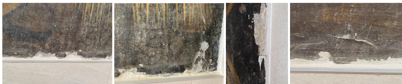
Fig. 46, 47, 48 y 49. Lagunas en zonas perimetrales. Borde inferior y lateral derecho. La Fig. 49 muestra delaminación.
