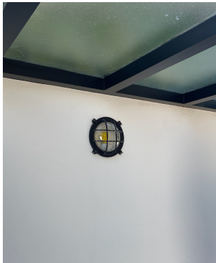
Fig 58. Luz de pared pasillo
