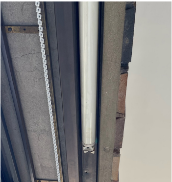
Fig 57. Tubos fluorescentes lineales
