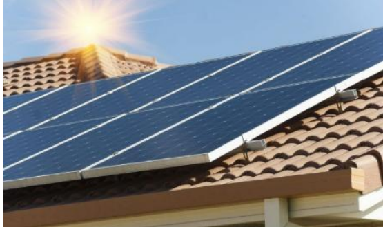
Figura 1.6.2.1.1. Instalación coplanar sobre cubierta orientada al sur. 30
