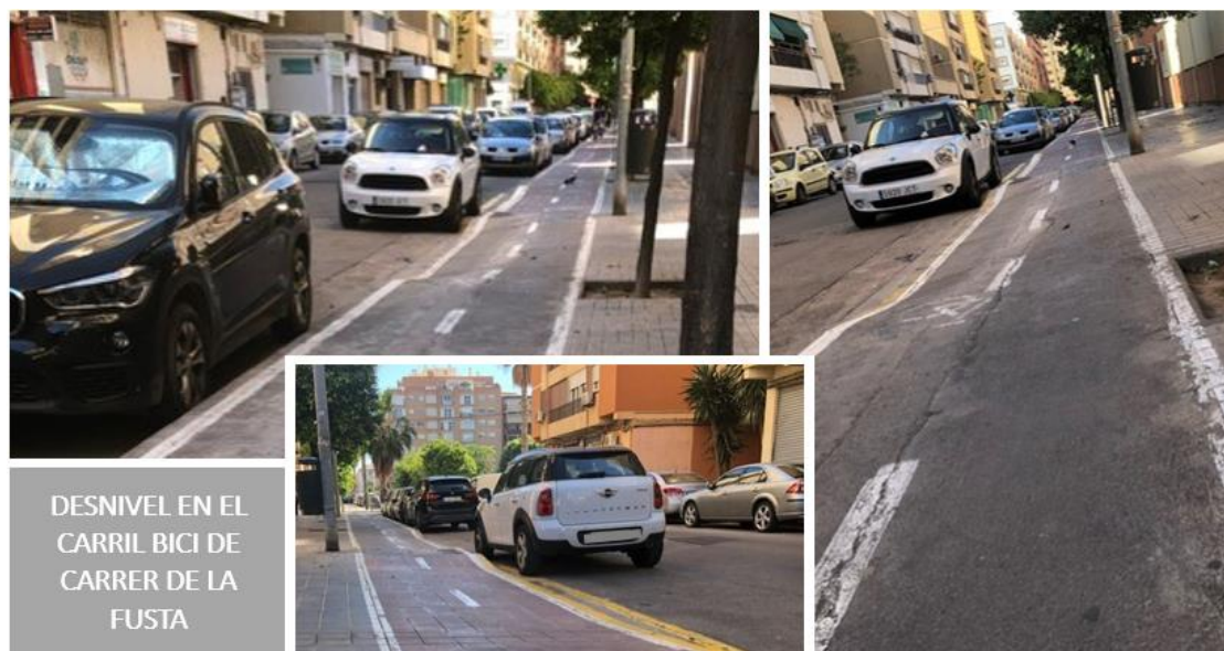
Figura 61. Desnivel en carril bici de calle Maderas. Fuente: Propia
