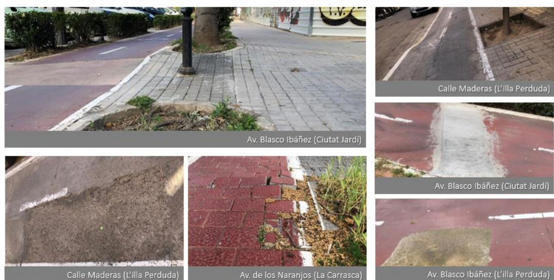
Figura 63. Deterioros en el pavimento de carriles bici del distrito Algirós. Fuente: Propia
