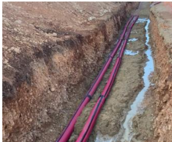
Figura 8. Canalizaciones subterráneas (Albaceteña, 2025)
