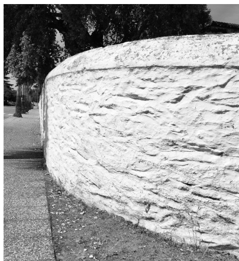
Fig. 4 Desaparición del acerado en la curva del muro perimetral del Colegio.
