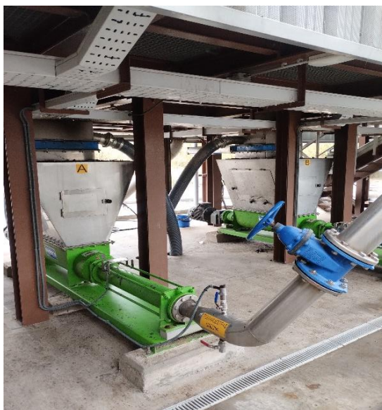
Figura 28. Impulsión y válvula de control del deshidratado
