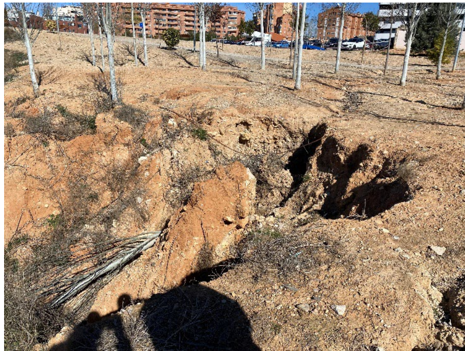
Imagen 4. Erosión provocada por las aguas de escorrentía en la cabeza del talud a estabilizar. Imagen tomada desde el talud objeto de estudio en dirección noroeste. Fuente: propia.
