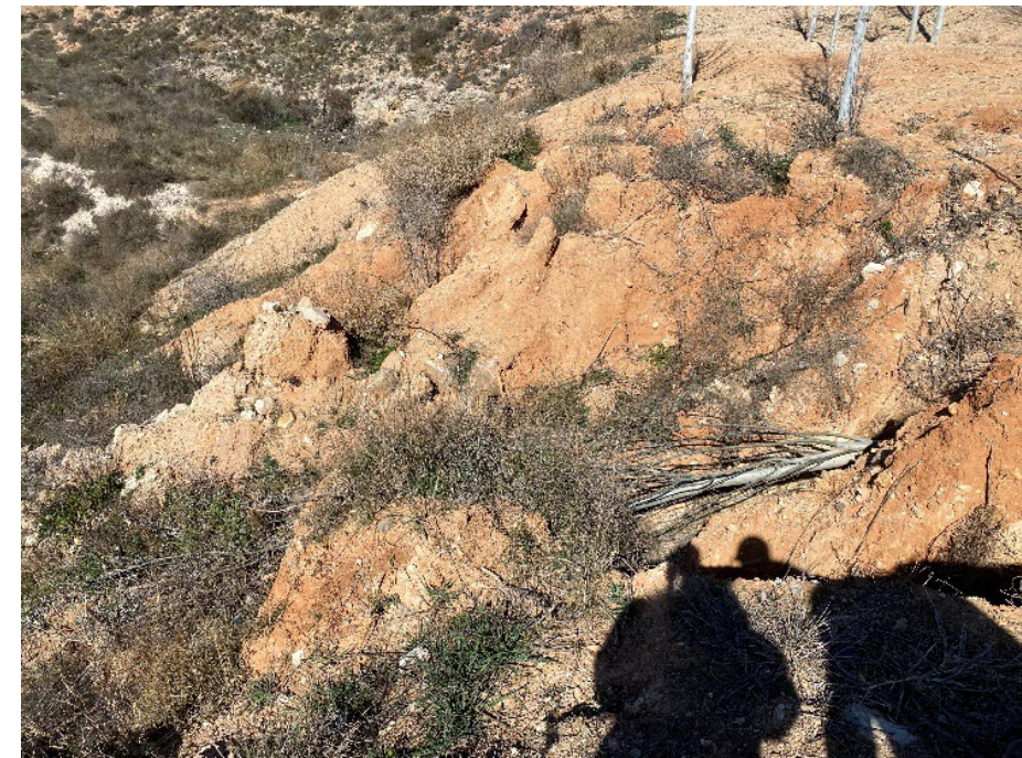
Imagen 6. Apreciación del estado del talud a estabilizar. Imagen tomada desde la zona sur del parque con orientación oeste. Fuente: propia.
