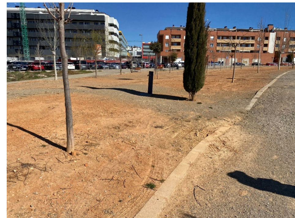
Imagen 11. Detalle de los daños existentes en los caminos del parque "Polígono Sur". Imagen tomada desde el camino perimetral a los taludes del parque con orientación norte. Fuente: propia.
