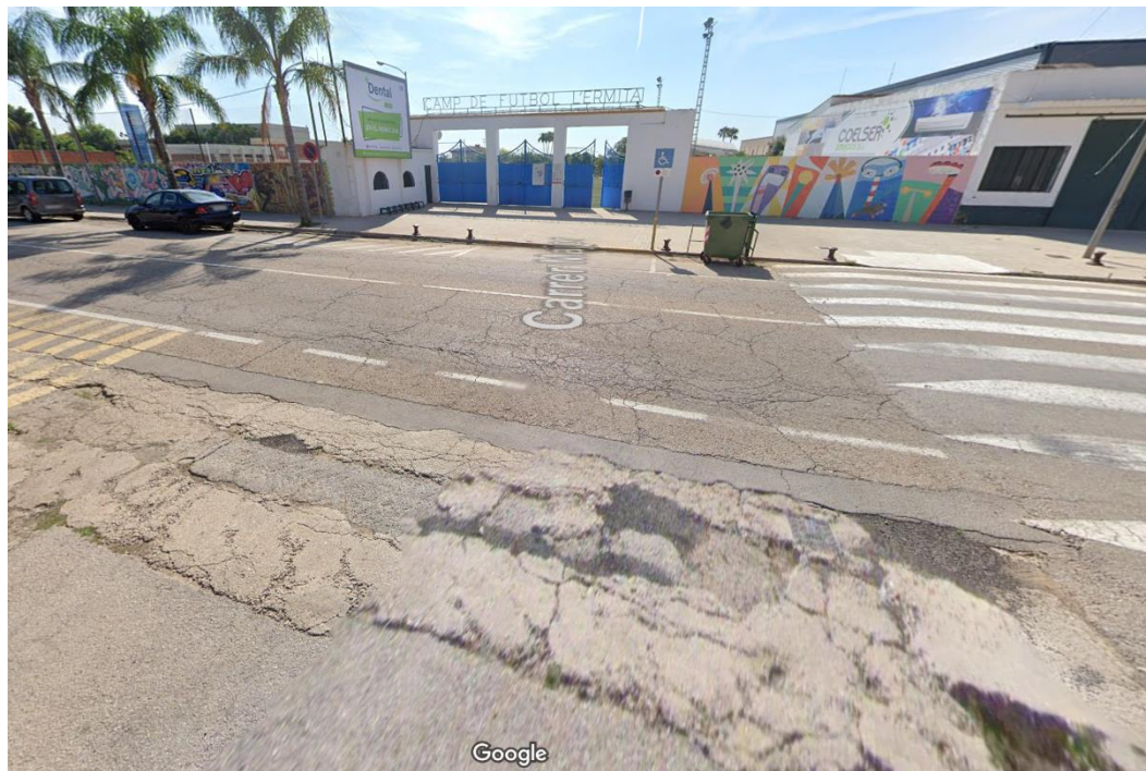
Figura 77: Estado de la calle Major (Google maps, )
