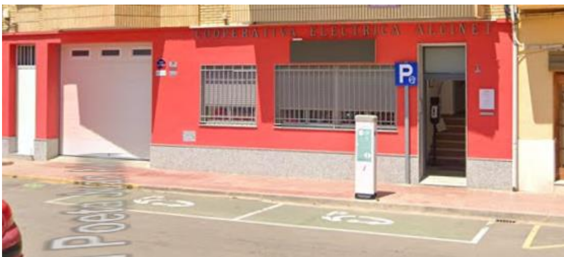
Figura 111: Punto de recarga de coches (Google maps, )
