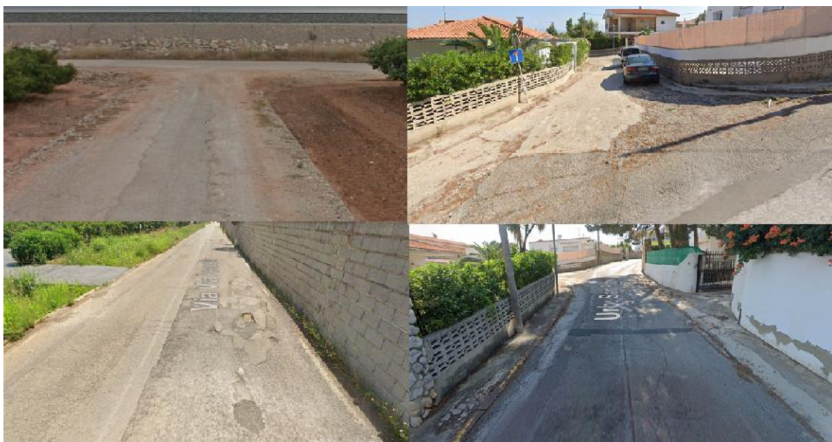
Figura 76: Estado de carreteras en vías pecuarias y fuera del casco urbano (Google maps, )
