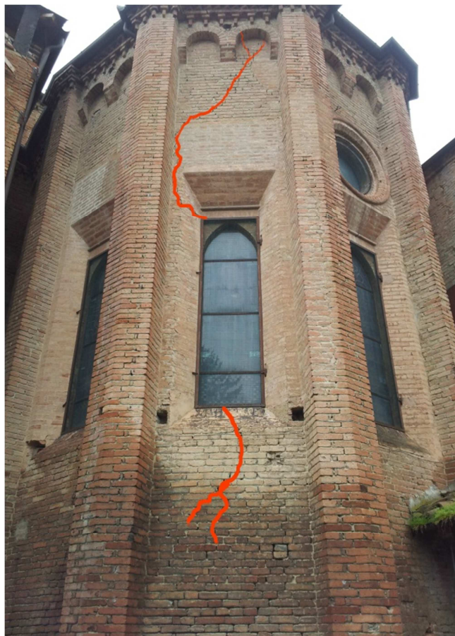
Figure 38: Spaccamento dell'abside nella zona de la finestra.
