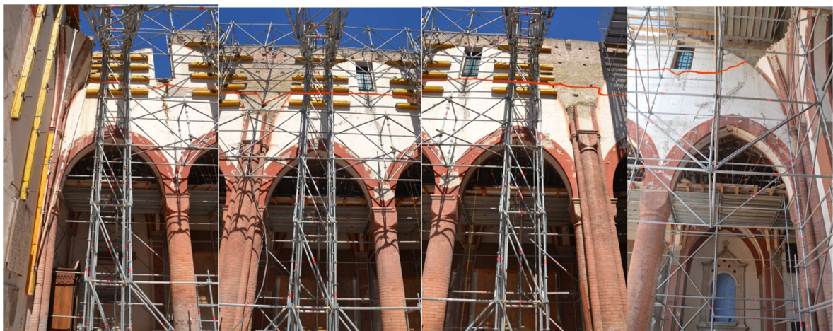
Figure 46: Fessurazione orizzontale dei muri per la spinta della copertura.
