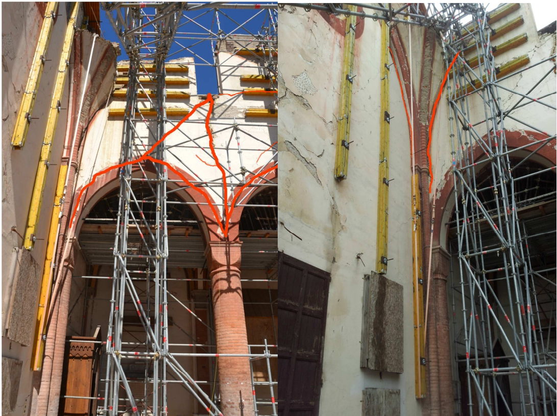
Figure 39: Spaccamento del muro nord della navata centrale e distacco della facciata.
