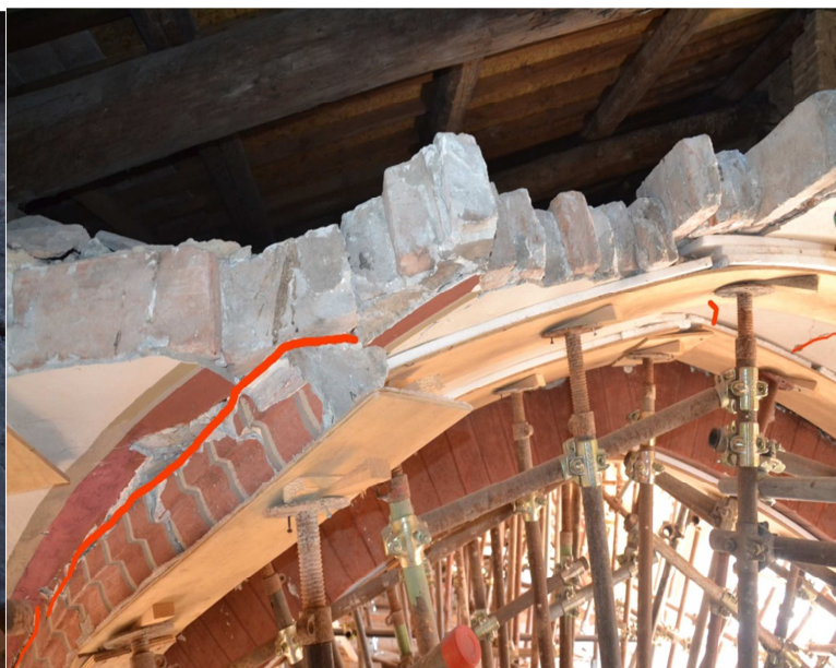
Figure 40: Daños de las bóvedas en la nave norte.
