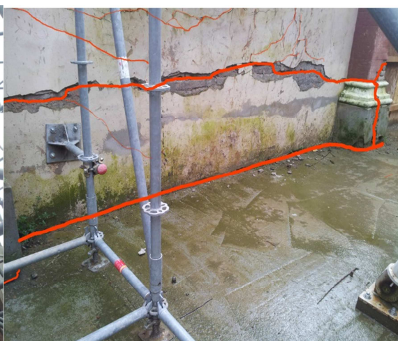
Figure 36: Derrumbe parcial del muro meridional y vuelco del muro permanente.
