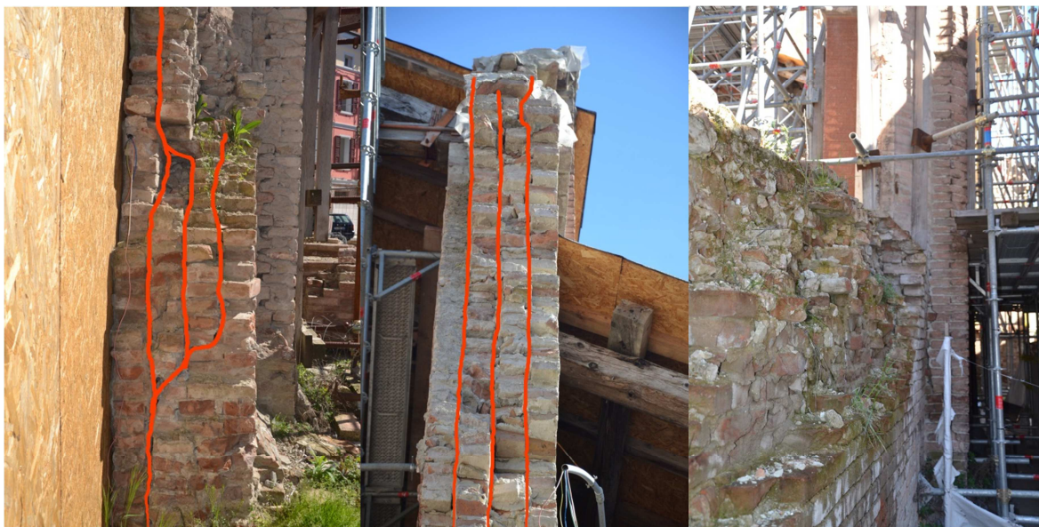
Figura 49: Dettaglio del collegamento della muratura nella parete debolita per l'apertura di vuoti e disgregazione per la tessitura della muratura.
