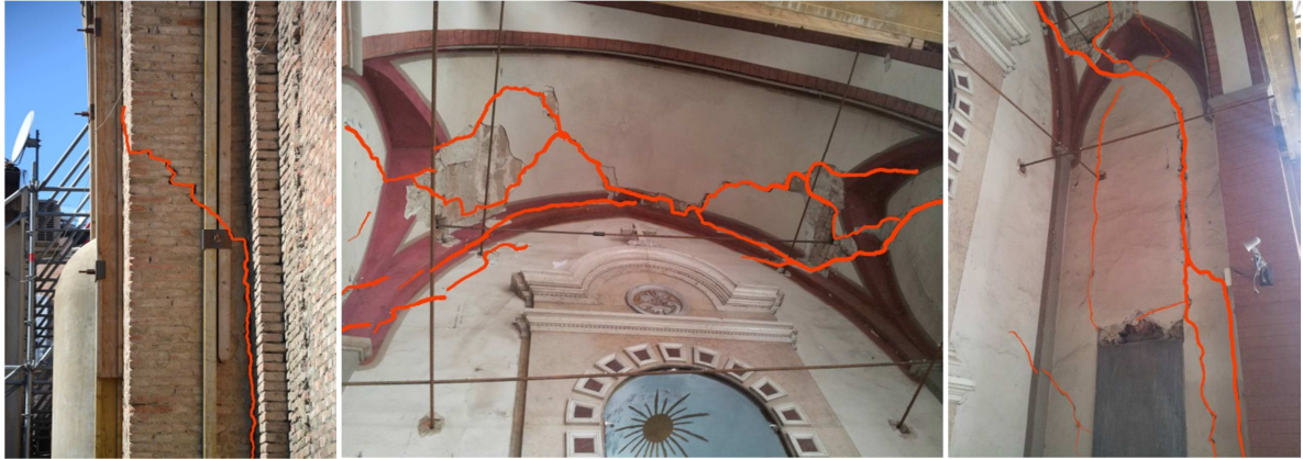
Figure 37: Spaccamento della cappella meridionale per la spinta delle volte.
