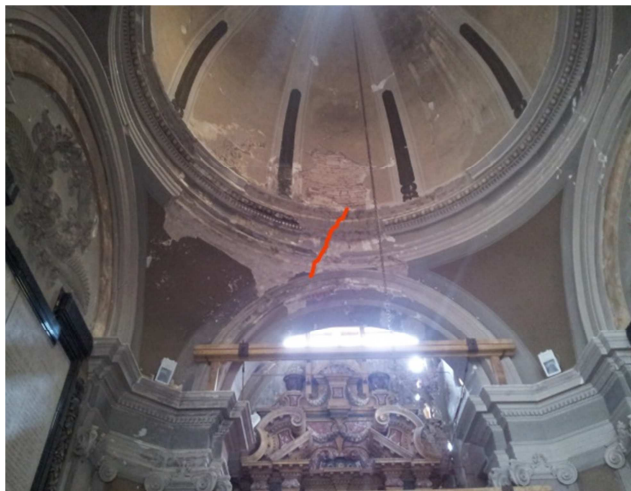
Figure 47: Fessure in cupola prima della cappella di B. Vergine di Reggio.
