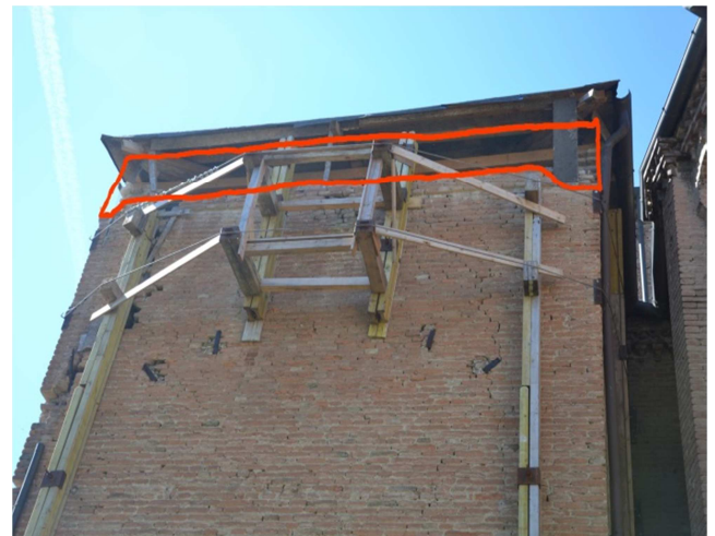
Figure 48: Ribaltamento della sommità del muro per la spinta della copertura.
