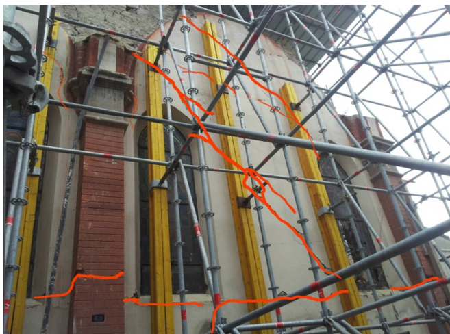
Figure 36: Crollo parziale del muro meridionale e giro del muro rimanente.
