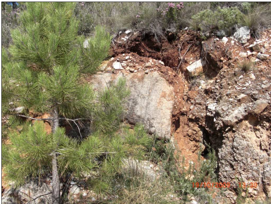
Figura 3.2: Desprendimiento de rocas.
