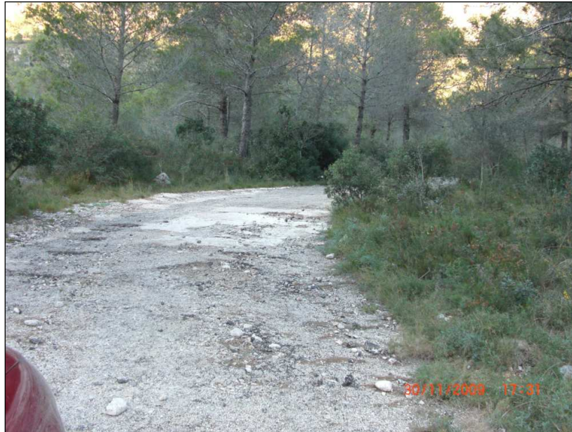
Figura 10.2: Firme en mal estado.
