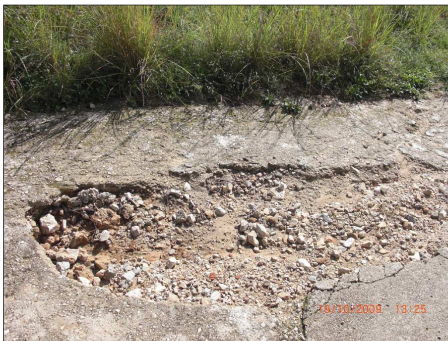
Figura 1.2: Agujero en el firme
