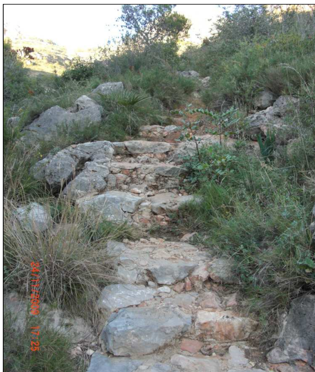
Figura 7.1: Escalones con piedras sueltas.
