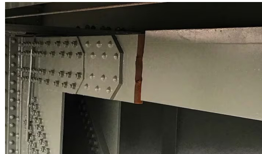
Fig. 1.5. Fractura por fatiga en el Delaware River Turnpike Bridge. Fuente: (Laughlin, 2017), cortesía de la Turnpike Comission
