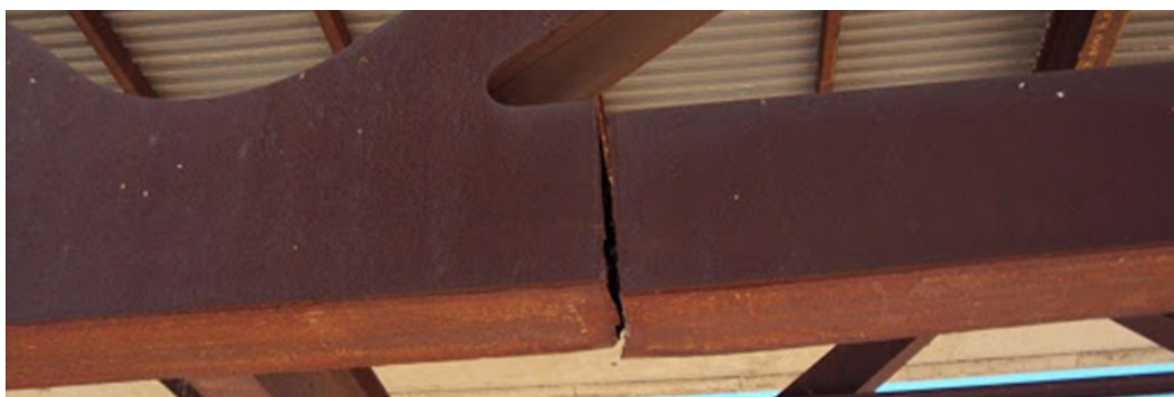
Fig. 1.6. Fractura por fatiga en el Viaducto de Contreras. Fuente: (Franc Levantina,2013)
