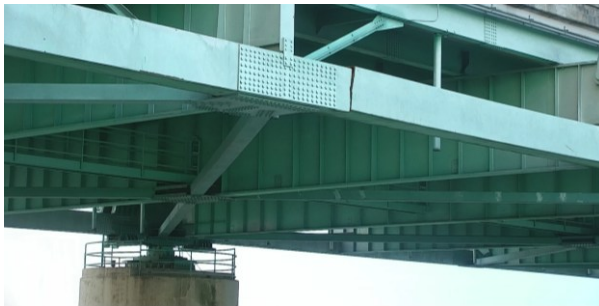
Fig. 1.4. Fractura por fatiga en el puente Hernando de Soto. Fuente: (Brawner, 2021), cortesía del ArDOT
