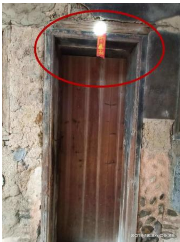
Foto 52 Situación de las termitas en la casa de Tiakun, Baisha 60
