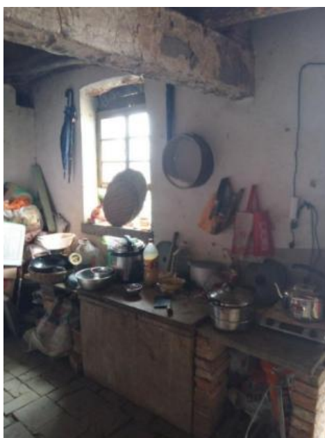
Foto 51 Daños en la estructura de madera de la cocina del Tulou 59
