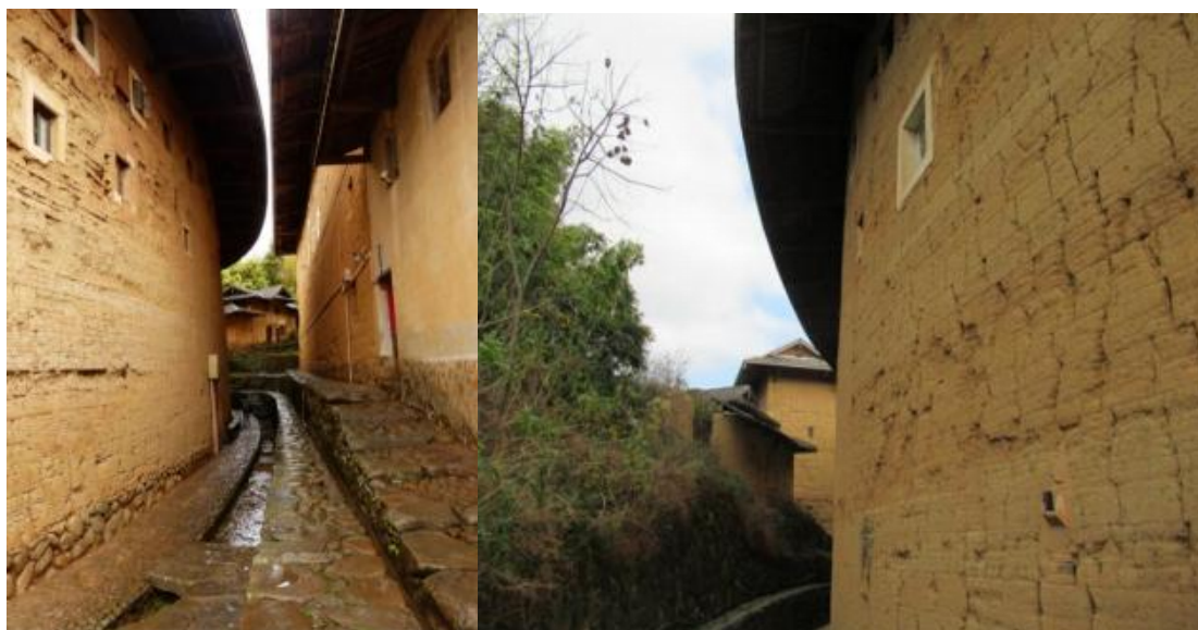
Tulou se agrieta debido a la contracción.
