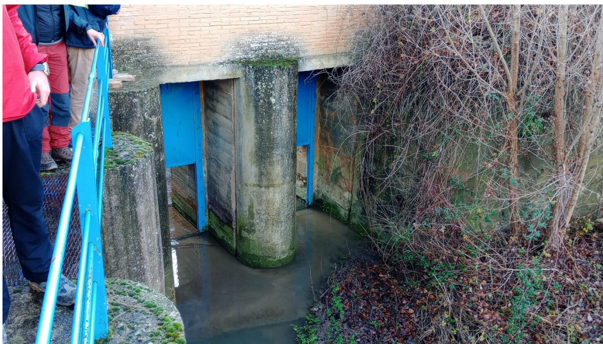
Figura 26.- Compuertas hacia canal de trasvase. Fuente: visita realizada a la presa.
