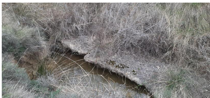
Figura 10.- Tramo con cajeros destruidos canal de descarga del aliviadero. Fuente: visita realizada.
