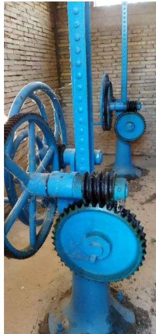
Figura 28.- Cierres de regulación caseta de derivación a la presa. Fuente: visita realizada.
