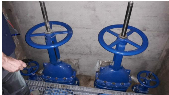
Figura 18.- Válvulas de seguridad en la pequeña cámara de compuertas. Fuente: visita realizada.
