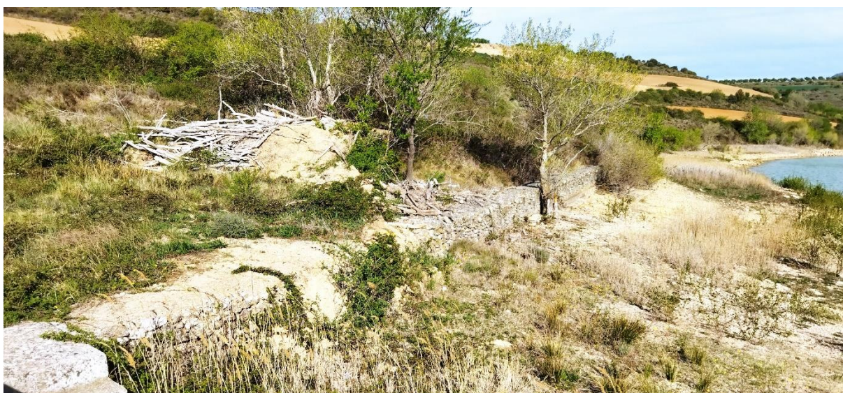
Figura 22.- Gaviones rotos en el estribo derecha. Fuente: visita realizada a la presa.
