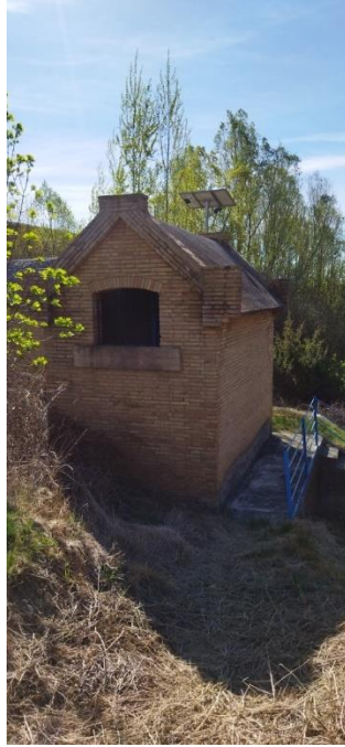
Figura 27.- Caseta de derivación a la presa. Fuente: visita realizada.
