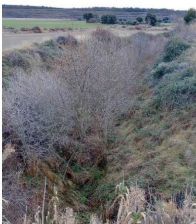
Figura 9.- Vegetación en canal de descarga del aliviadero después de los tubos. Fuente: visita realizada.
