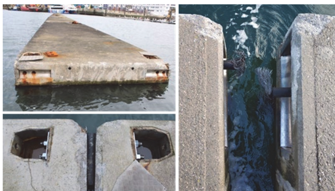
Fig. 1. Dique flotante modular de tipo pontón en funcionamiento (panel superior izquierda), detalle de conexión entre módulos flotantes (panel inferior izquierda) y rotura de conexión (panel derecho)
