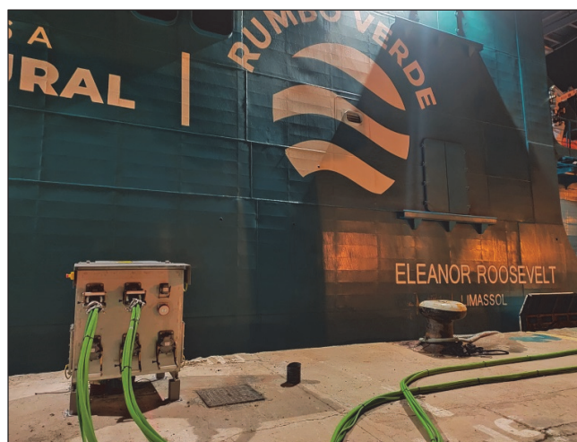
Fig. 6: Conectores en borde de muelle en BT, conectados a buque. Sistema OPS en muelle de Perares, Palma. Fuente: elaboración propia.
