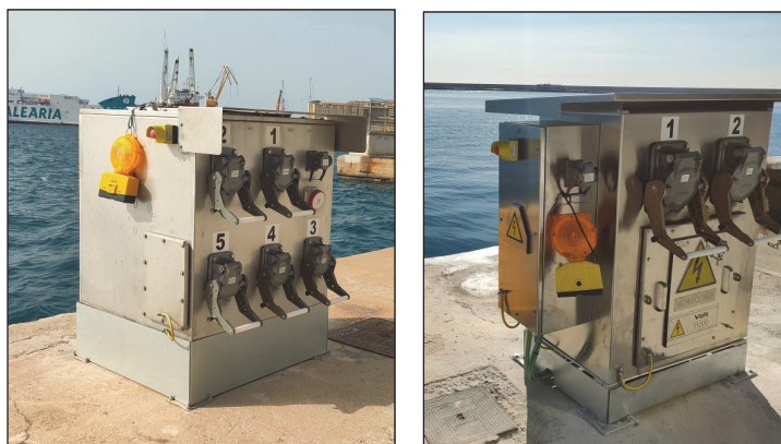
Fig. 5: Conectores en borde de muelle, BT y MT, respectivamente. Sistema OPS en muelle de Perares, Palma. Fuente: elaboración propia.
