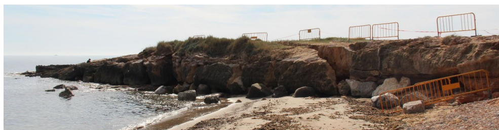
Fig. 2. Apertura de grietas y socavación del pie del acantilado de Cala Piteras (Torrevieja) como consecuencia del temporal Gloria.
