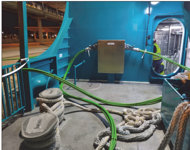
Fig. 9: Conexión en media tensión en cubierta de buque Eleanor Roosevelt, de Baleària. Fuente: Autoridad Portuaria de Baleares (2021).
