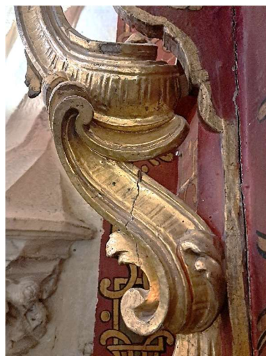
Figura 60. Grietas en la ornamentación, 2025. Elena Valbuena Miralles.
