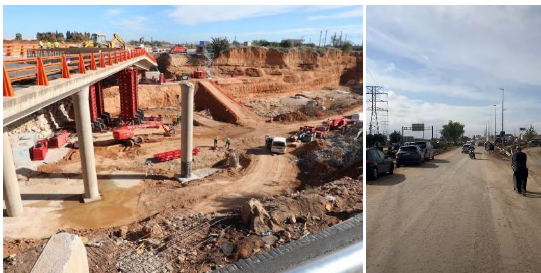
Figura 43: Vías de comunicación impactadas por la DANA (fuente: desconocida)
