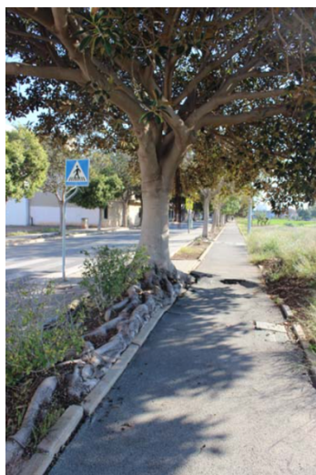
Figura 16. Detalle de los daños en la calzada por el tamaño de las raíces.
