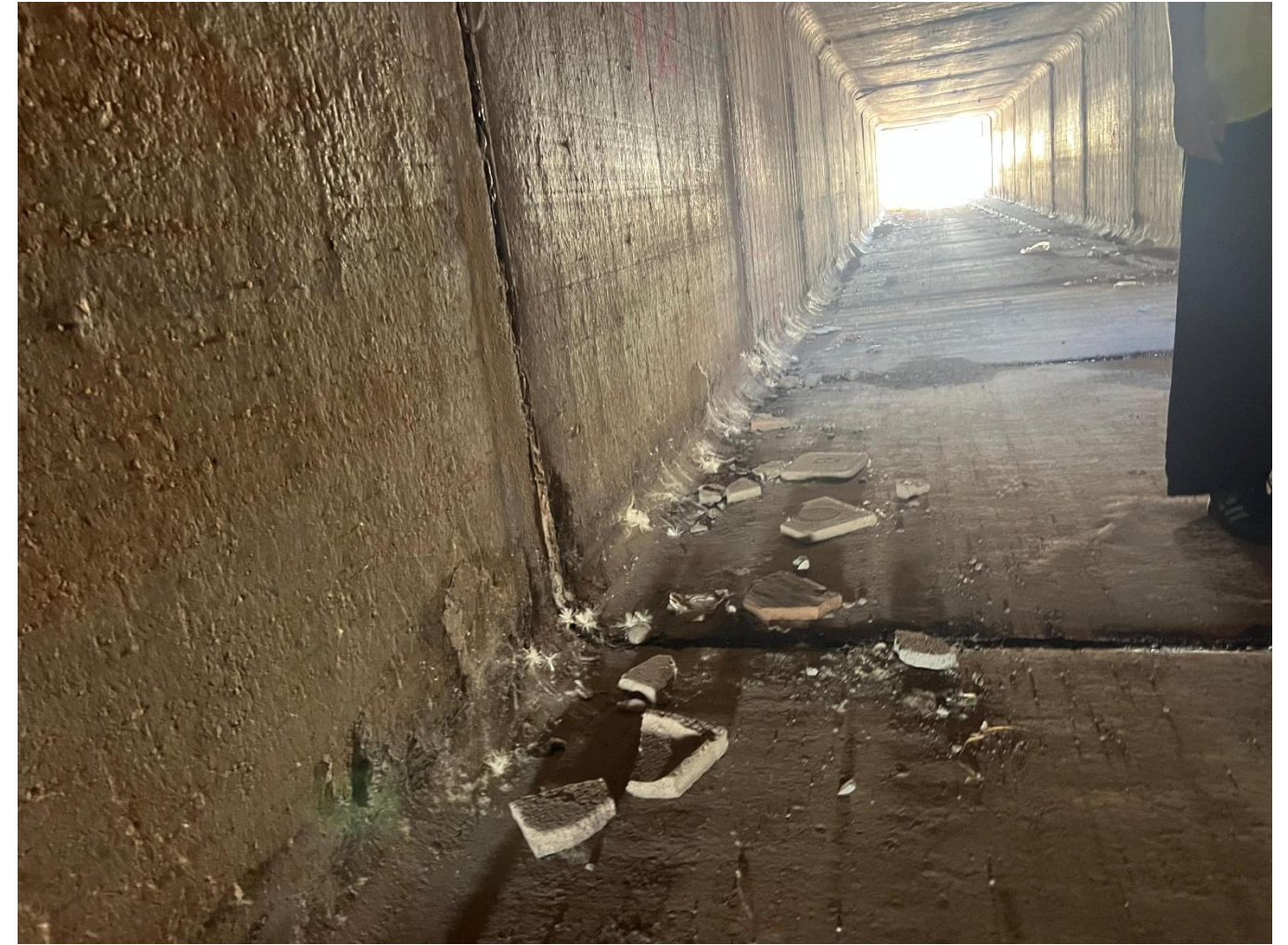
Ilustración 6. Descorchamiento del hormigón en ODT. Fuente: Elaboración propia
