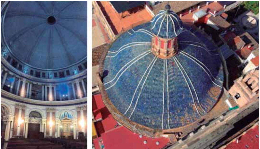
Vistas interiores y aéreas de la Iglesia de las Escuelas Pías de Valencia / Vedute interne e aeree della Chiesa delle Scuole Pie di Valencia / Interior and aerial views of the Church of the Pious Schools of Valencia / Vues intérieures et aériennes de l'église des Ecoles Pies de Valence.
