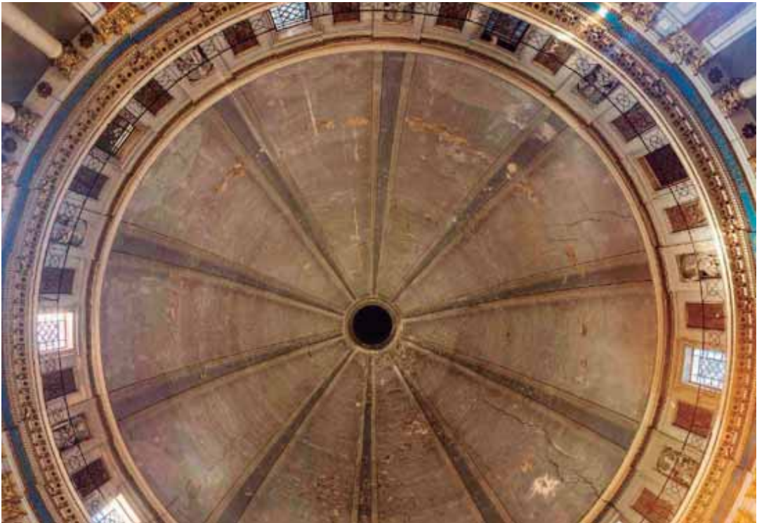
Estado de la cúpula antes de la intervención / Stato della cupola prima dell'intervento / Condition of the dome prior to the intervention / État du dôme avant l'intervention
