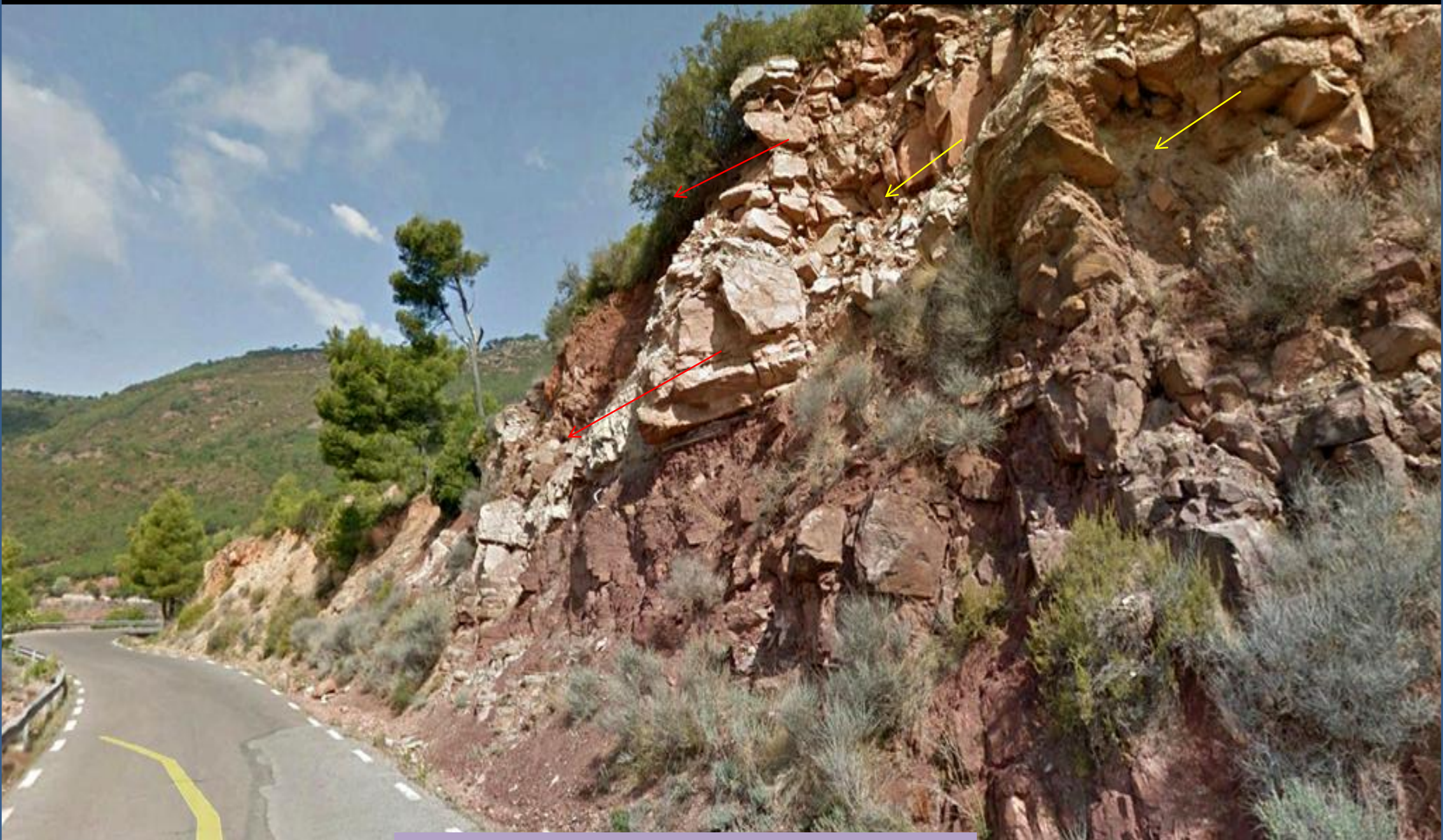
Junto anterior: Peligrosidad en carretera. Areniscas del Buntsandstein, Triásico Inf. Castellón. NW de Benicasim. SE Hoja de Villafamés.
