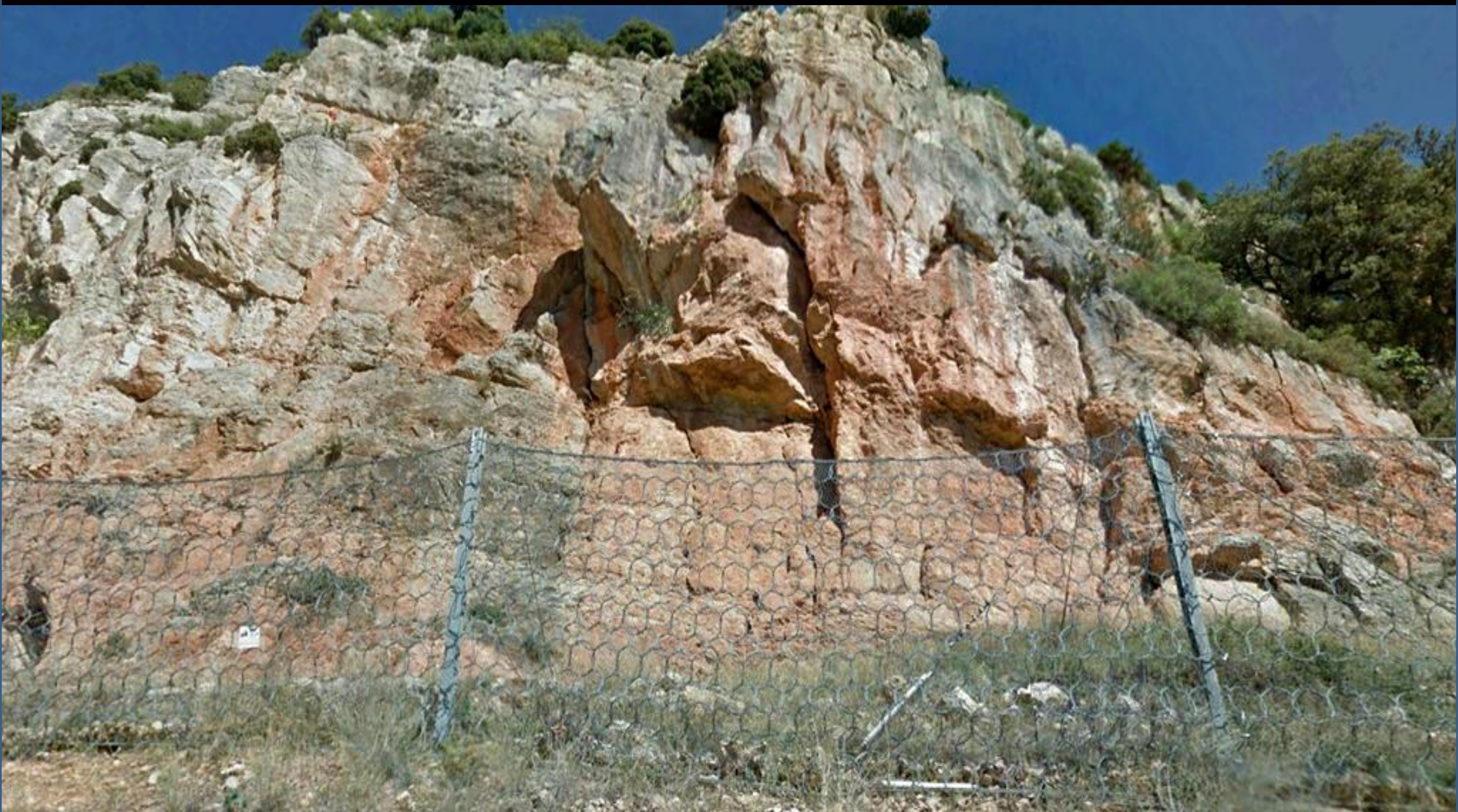
Detalle de anterior: Zona de peligrosidad de caída de bloques a la carretera. Calizas del Gargasense, Cretácico Inf. SE de Chodos, Castellón. Centro SE Hoja de Villahermosa del Río.
