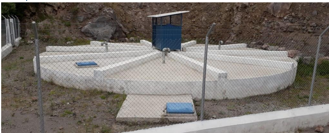
Figura 8: Depósito de regulación sector Barrios Altos.
