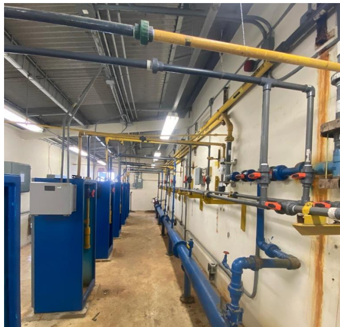
Figura 10. Dosificación de cloro
