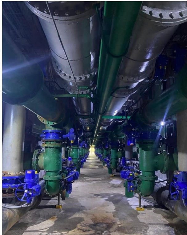
Figura 18. Cámara de válvulas del sistema de filtrado
