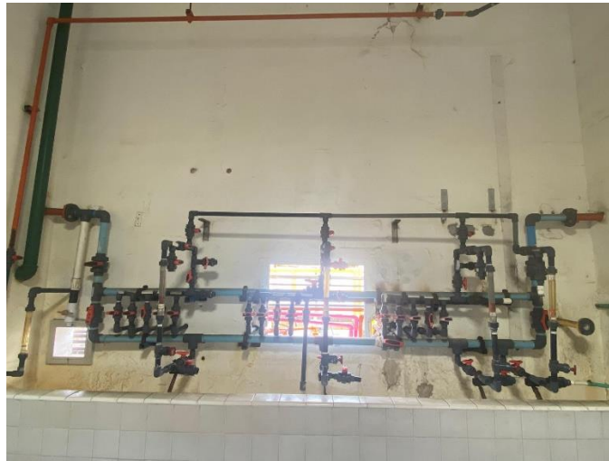
Figura 9. Dosificación de coagulante por gravedad
