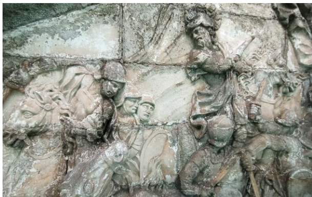
Figura 2. Restos de albayalde del tímpano central de la fachada de Pazo de Raxoi en Santiago de Compostela
