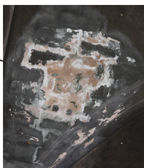
Figura 31. Manchas de humedad, eflorescencias salinas y velados.
