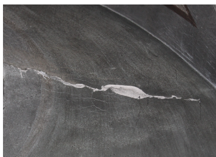
Figura 19 (Izquierda). Grieta situada en una de las paredes que dan al exterior. Próxima a la ventana.
