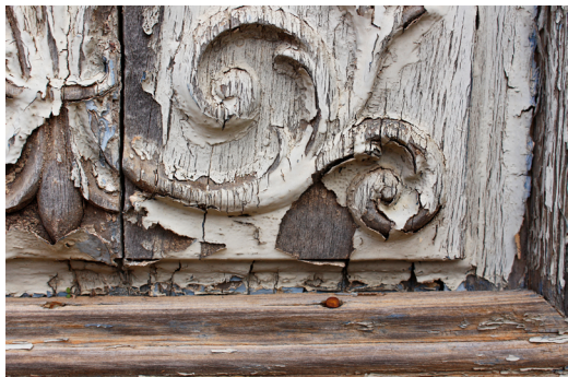
Fig. 29 Detalle de los desprendimientos de la pintura
