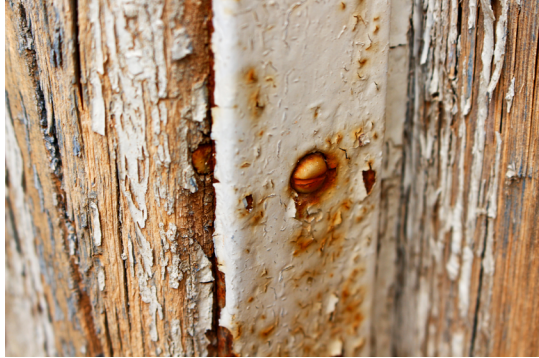
Fig. 25 Detalle elemento metálico oxidado
