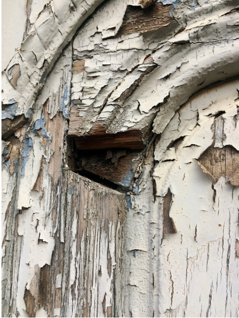
Fig. 23 Detalle pieza faltante
