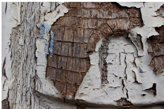
Fig. 17 Detalle pudrición cúbica
