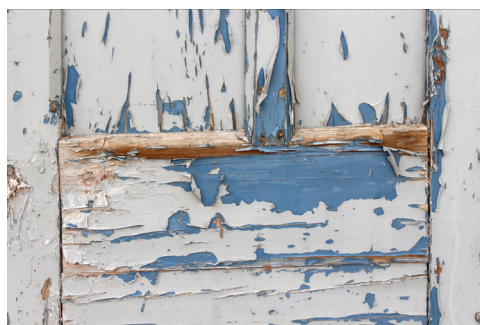
Fig. 10 Detalle levantamiento de la pintura
