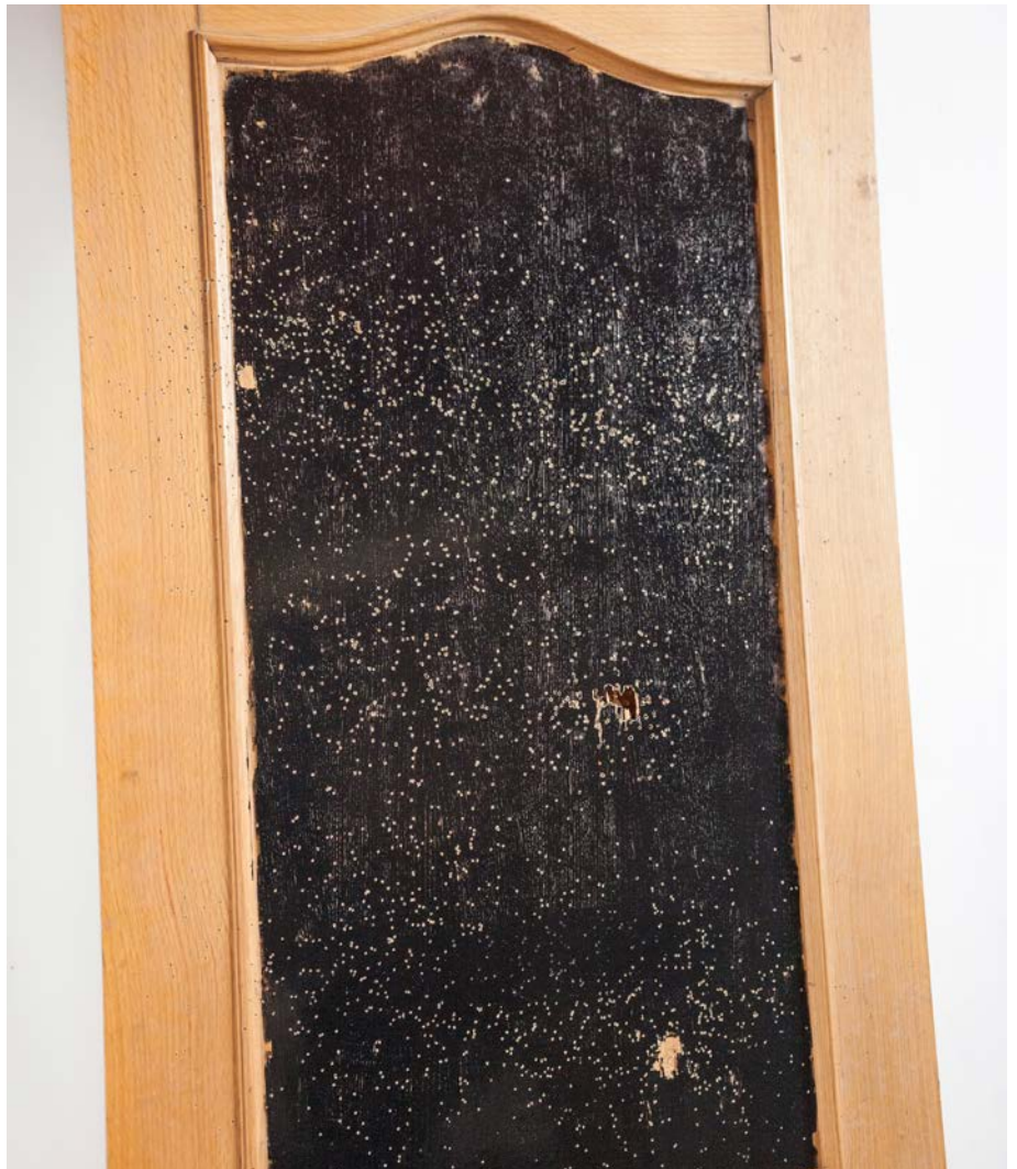
Detalle puerta 3. Al entintar la zona afectada por los tiros se puede observar perfectamente la huella que estos han dejado.
