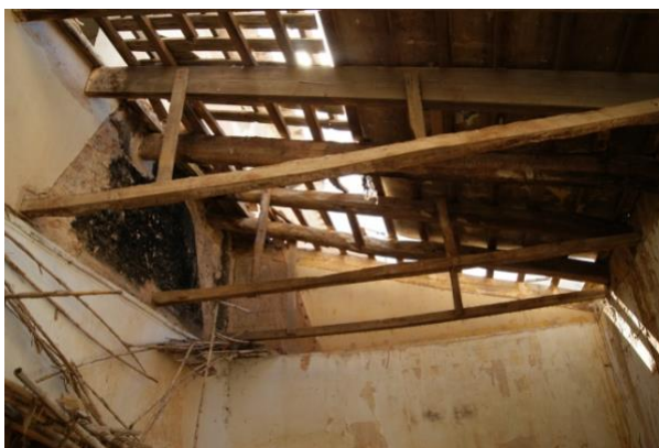
Figura 3. Estructura de cabirones de madera suspendidos del forjado inclinado de la cubierta para sustentar el falso techo en el Mas del Baló
