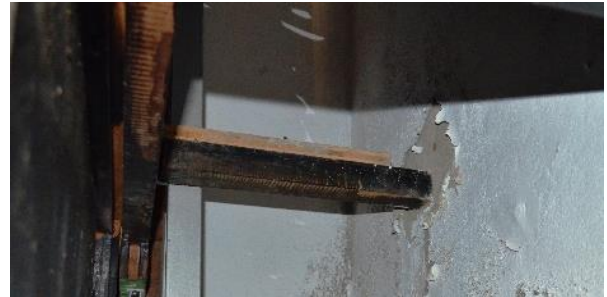
Figura 15. Tirante apoyado al muro
