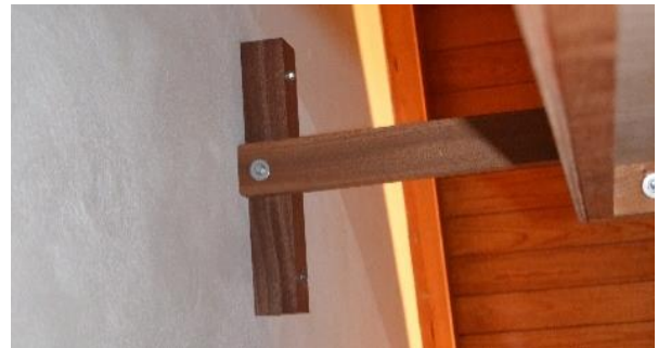
Figura 16. Travesaño sujeto al muro mediante tornillos
