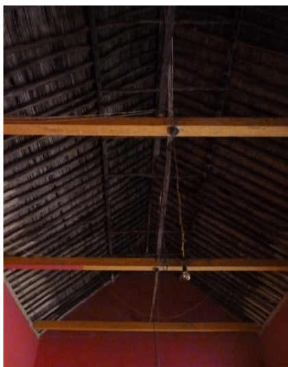
29. Imagen de la estructura de par y nuedillo en inmueble en el centro histórico de Mompox.
