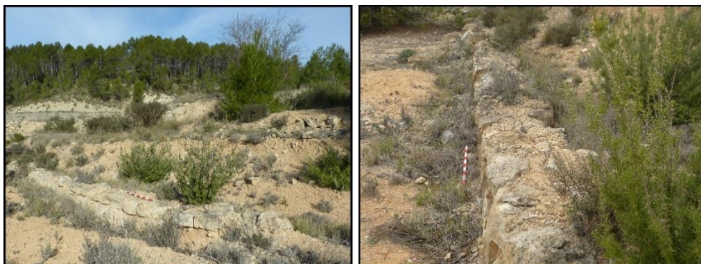
Figura 3.25. Vista longitudinal del muro de cierre y detalle de la técnica de ejecución a partir de varias hojas.
