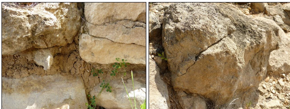
Figura 3.66. Visible proceso de ramificación, fisuras y grietas en los morteros y elementos pétreos.
