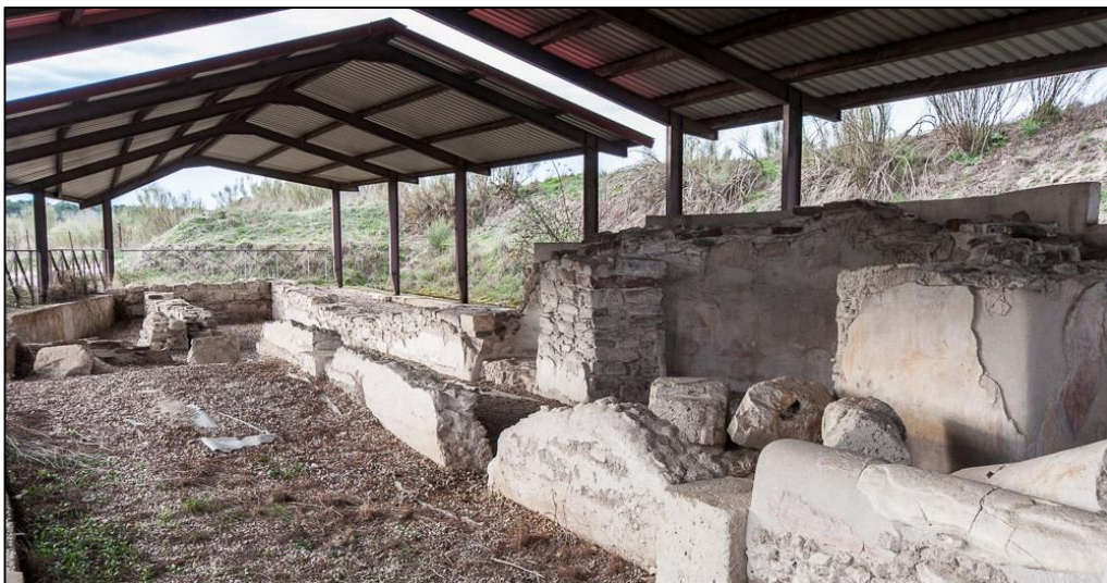
Figura 2.3. Cubierta y estado de abandono y visible degradación de la domus romana de Los Cinco Caños (Coca, Segovia). Fuente: http://www.terranostrum.es
