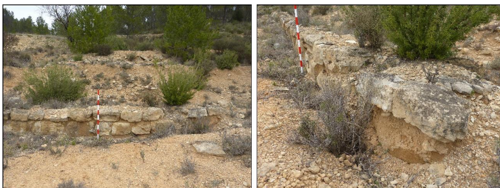
Figura 3.61. Situación de los bajos de los muros debido al ascenso de la humedad por capilaridad y lo que ello conlleva.
