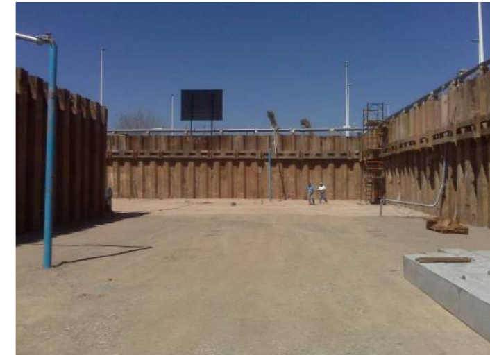
Ilustración 49: Ejemplo de pozos. Fuente: Empresa Ferrer S.L.
