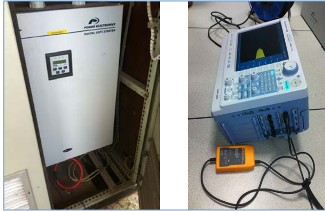
Fig. 115. Detalle del arrancador (Izda.) y del equipamiento para efectuar la captura de corrientes (Dcha.)
