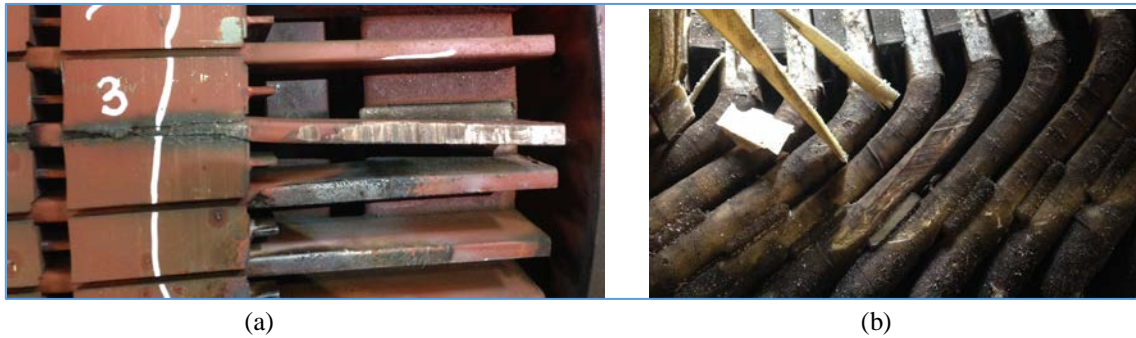
Fig. 19. Fallo catastrófico en motor de 3,3kV y 450 kW operando en una refinería debido a: protrusión de barra (a), con el consiguiente daño sobre el aislamiento (b) [ANTONINO 18 2016].
