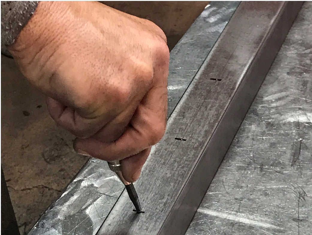
Imagen 5. Marcaje de tubos
