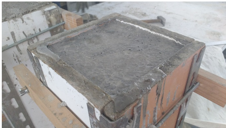
Ilustración 9. Retracción del hormigón
