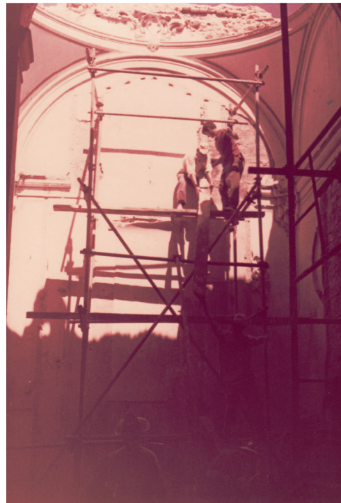
Fig. 47 - Interior de la capilla de la Merced durante la restauración de 1968 (AMP).
