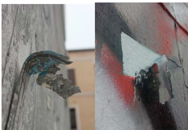
ILUSTRACIÓN. 6. Daños. Desahdesión en 2015 y 2017.
