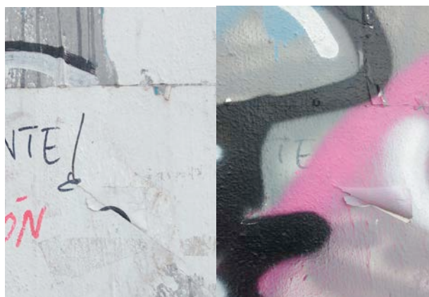
ILUSTRACIÓN. 7. Daños. Tag y graffiti en 2015 y 2017.
