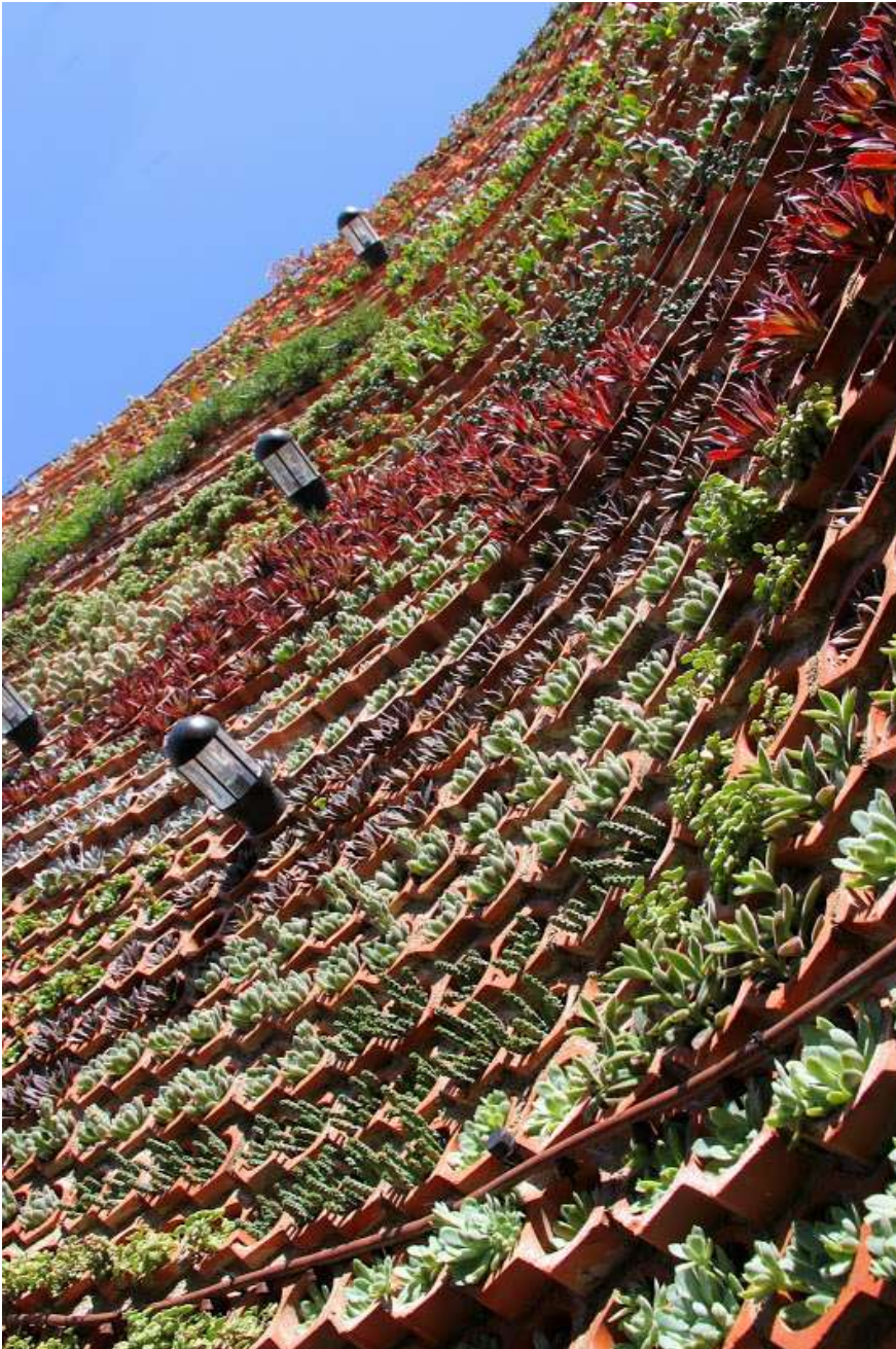
Imagen 48. Ejemplo Fachada vegetal sistema Eco Bin (discoteca Usuhaïa en Ibiza).
