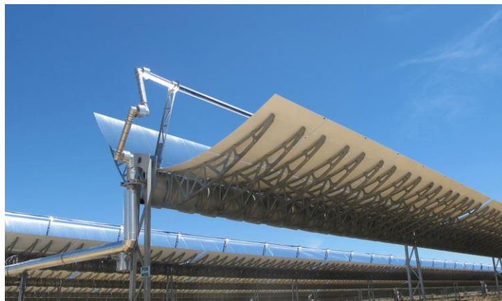
Imagen 3. Detalle campo solar Valle 1
