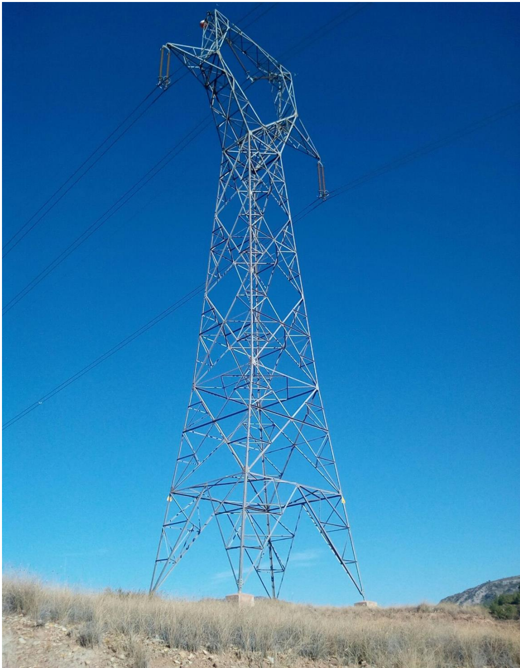
5. Poste eléctrico de alta tensión
