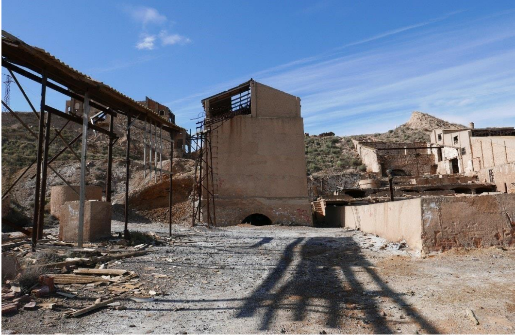
Fotografía 9. Detalle instalaciones en estado ruinoso 2
