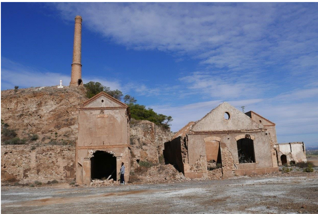
Fotografía 8. Detalle instalaciones en estado ruinoso 1
