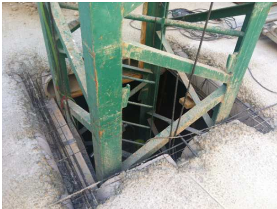
Estado de la unión del forjado con la grúa después del hormigonado.
