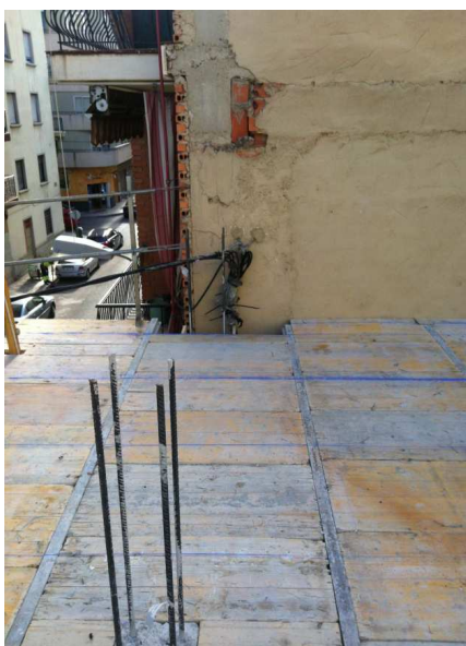
Cables de alta tensión que nos dificultan el trabajo.
