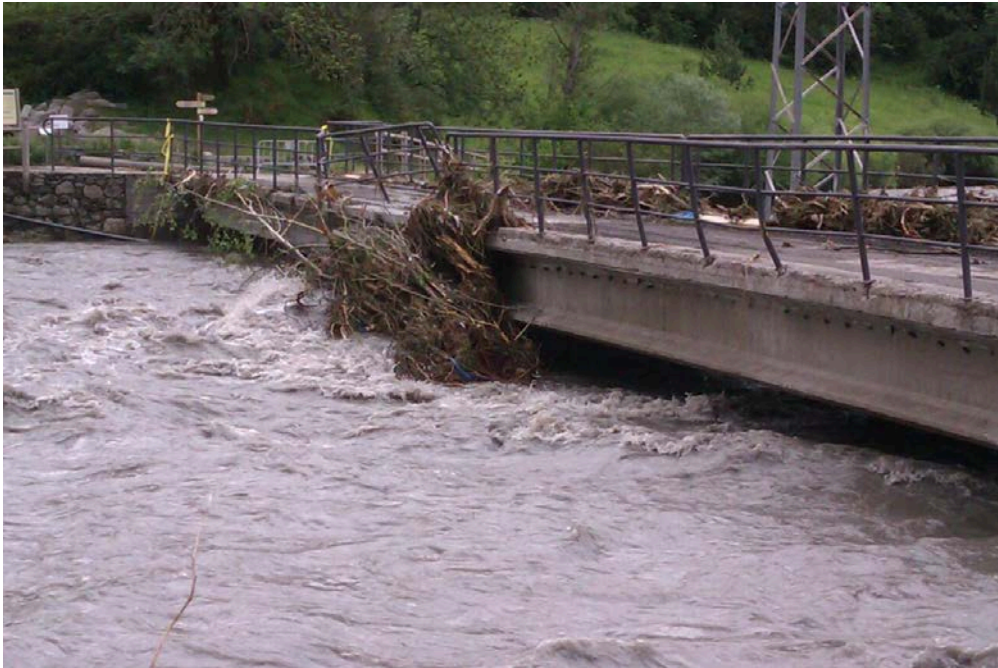
ILUSTRACIÓN 2: PUENTE LINSOLES EN ERISTE (RIADA DE 2013)
