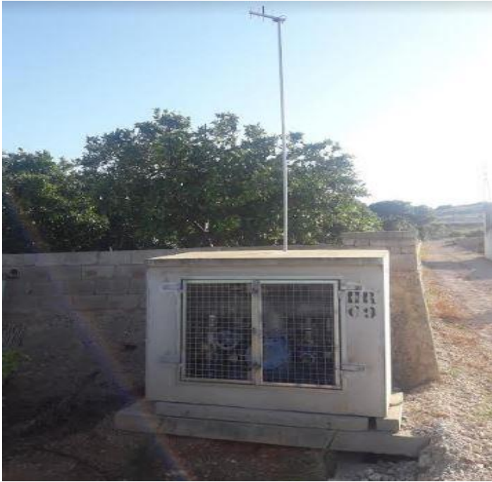
Imagen 5. Instalación que contiene las electroválvulas. Fuente elaboración propia.
