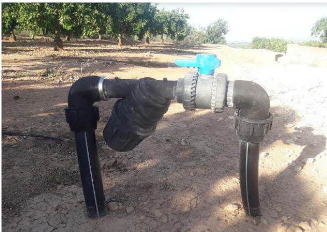
Imagen 6. Filtro instalado en el campo de naranjos de riego a goteo. Fuente elaboración propia.
