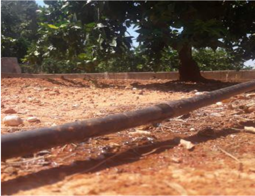
Imagen 4. Campo de naranjos de riego por goteo. Fuente: elaboración propia.
