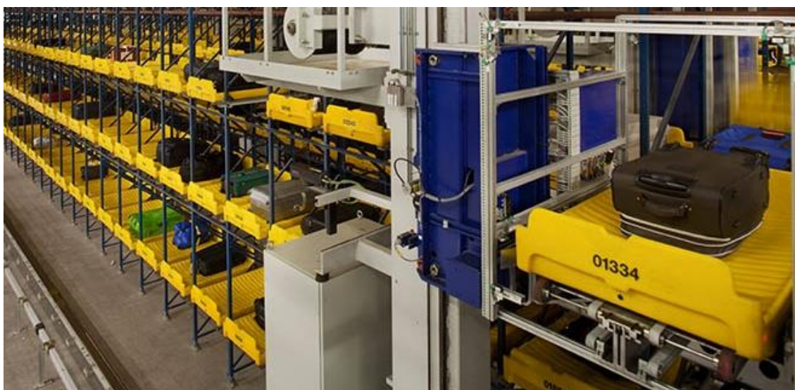
FIGURA 30. FOTOGRAFÍAS DEL SISTEMA DE TRATAMIENTO DE EQUIPAJES TEMPRANOS DEL AEROPUERTO DE ÁMSTERDAM – SCHIPHOL (FABER, 2013).
