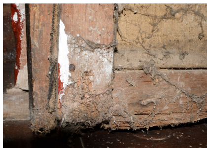
Fig.41: Suciedad acumulada en la zona inferior del bastidor.
