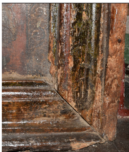
Fig.40: Unión a inglete y detalle de la zona barnizada del marco.
