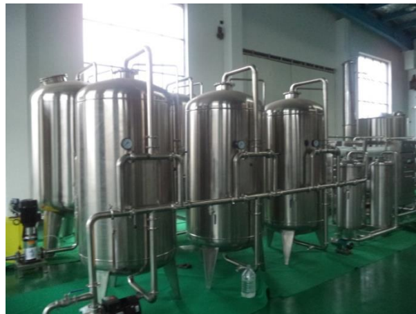
Ilustración 12: Tanques de almacenamiento.
