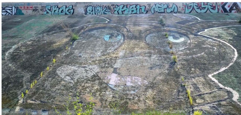
Figura 24: Fotografía general de la obra. Se aprecian las zonas donde la suciedad se ha depositado.
