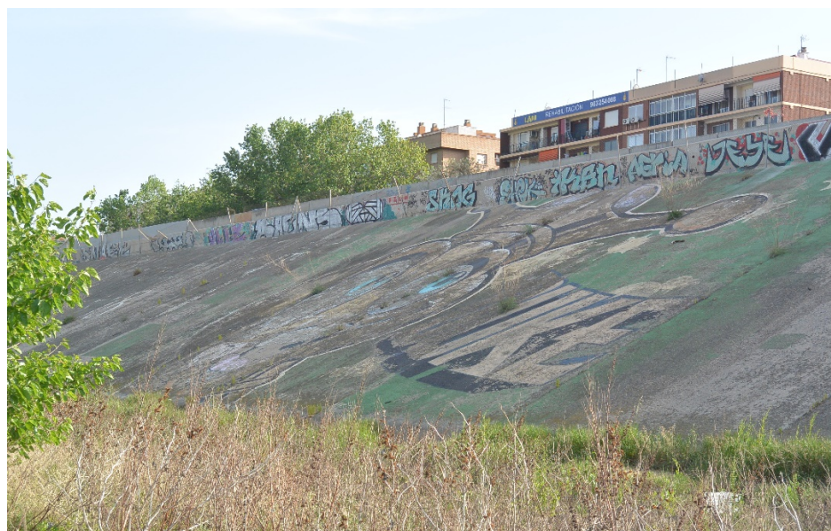
Figura 31: Estado de conservación actual de la obra visto desde el río. 20 de abril de 2018.
