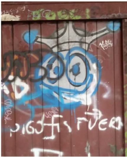
Detalle del estado general de conservación. Se aprecian las pintadas con aerosol que dificultan la correcta lectura de la obra.
