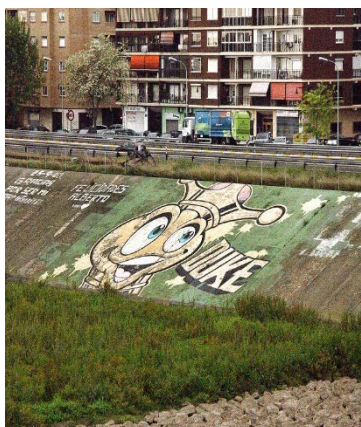
Figura 30: Fase de degradación de la obra en 2011.
