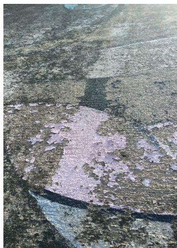
Figura 20: Detalle de la pérdida y descamación de la película pictórica
